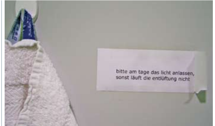
Gebäudeautomation und die Tücken in der Praxis
